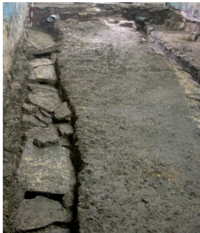
FOTO 4: Imagen de la atarjea bajomedieval, que corre paralela al muro occidental de la construcción, una vez retirado el suelo que la cubría. Su relleno, compuesto de sedimentos arenosos muy limpios, ausentes de materia orgánica y basuras –se han recuperado escasos y muy pequeños fragmentos de cerámica–, indica su uso como conducción de agua limpia y no como colector de evacuación de aguas fecales.
